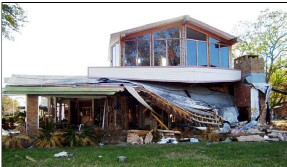
Propiedad costera destruida por marea huracanal.
